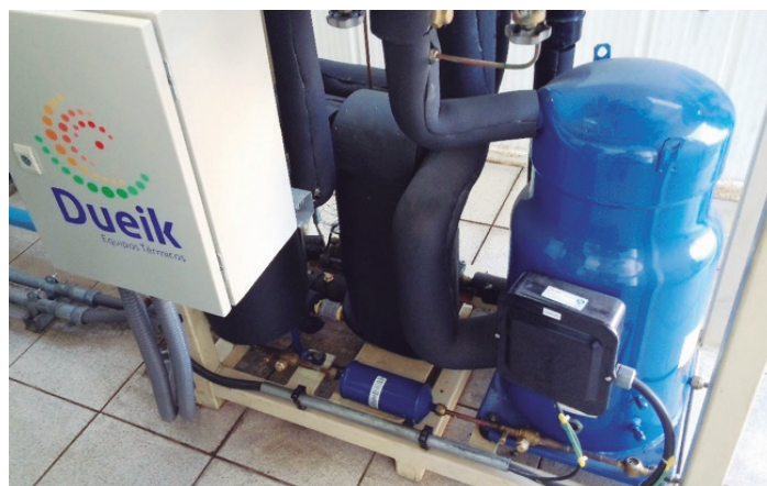
Foto N° 1: Bomba de calor instalada. FDF.
