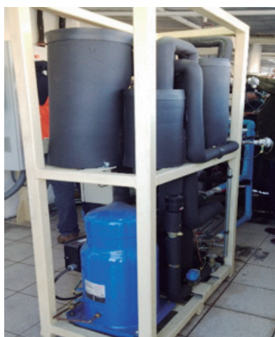
Foto N° 2: Vista general de la instalación. FDF.
